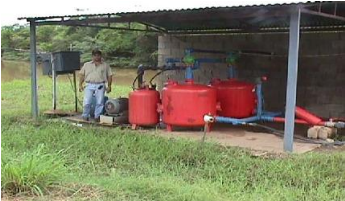
Figura N°1.- Cabezal del sistema de riego Fundadores
